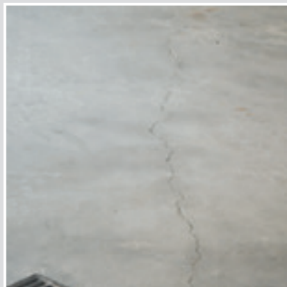
2 Scheuren in dekvloer kunnen eenvoudig en veilig worden gevuld.
