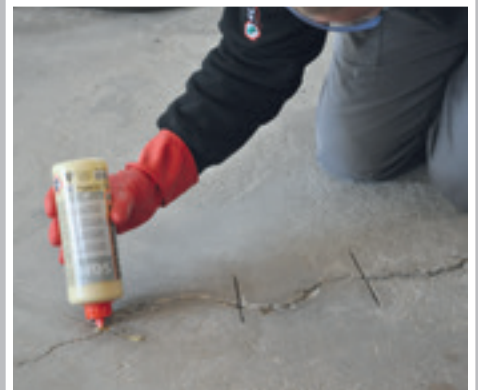
Tule van de fles op maat van de scheur afknippen en vullen
